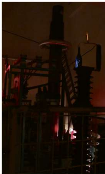
Fot. 2. Transformatory dostarczające napięcie 40 tys. volt pozwalają prezentować doświadczenia z wyładowaniami elektrycznymi
