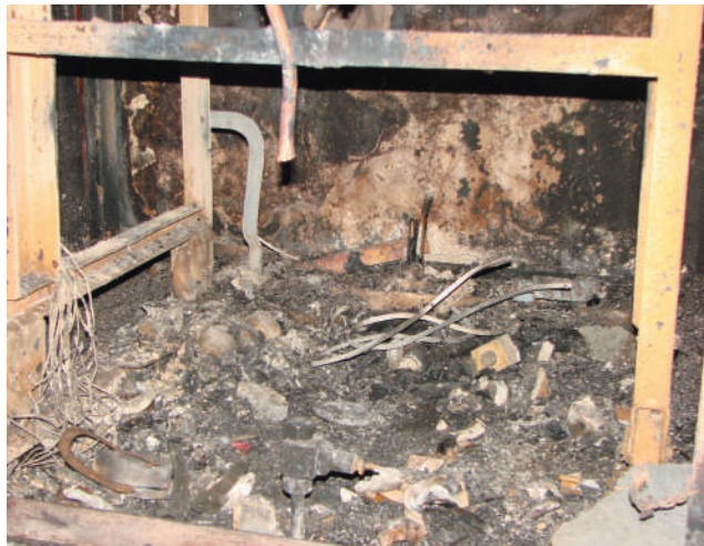
Rys. 3. Prawdopodobne miejsce powstania zwarcia. Przyłącze kablowe
