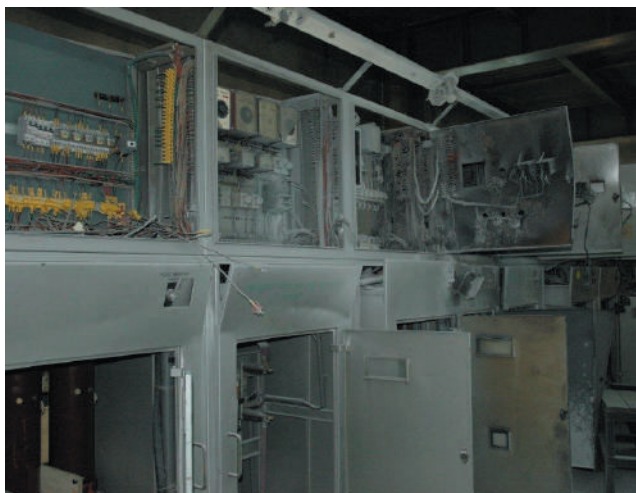
Rys. 6 i 7. Uszkodzone pole – widok na przednią elewację
