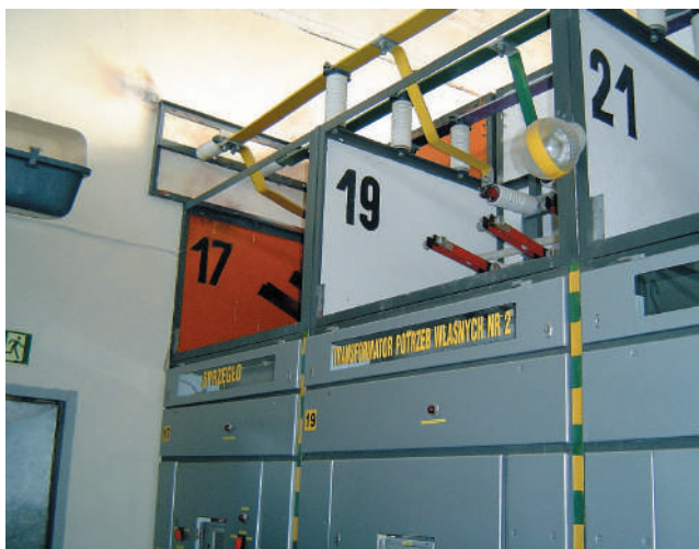
Rys. 15. Miejsce zwarcia – uszkodzony izolator wsporczy Fig. 15. Place of short circuit – damaged supporting insulator
