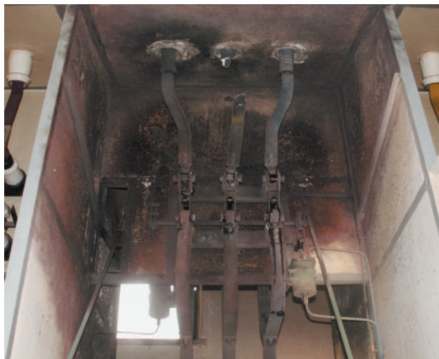
Rys. 8. Miejsce zwarcia: przyłącze szyn
