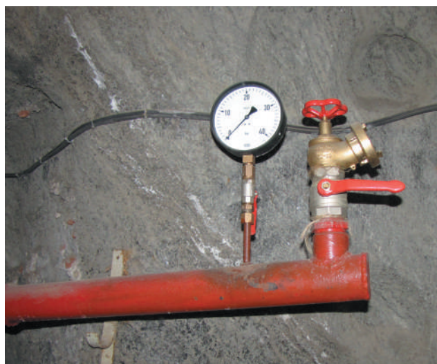
Rys. 2. Końcówka rurociągu przeciwpożarowego na ociosie solnym
