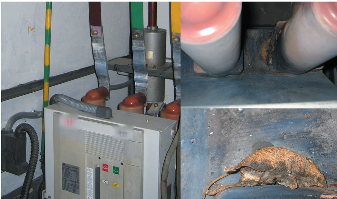
Rys. 13. Miejsce, w którym doszło do zwarcia – obszar pomiędzy komorami wyłącznika
