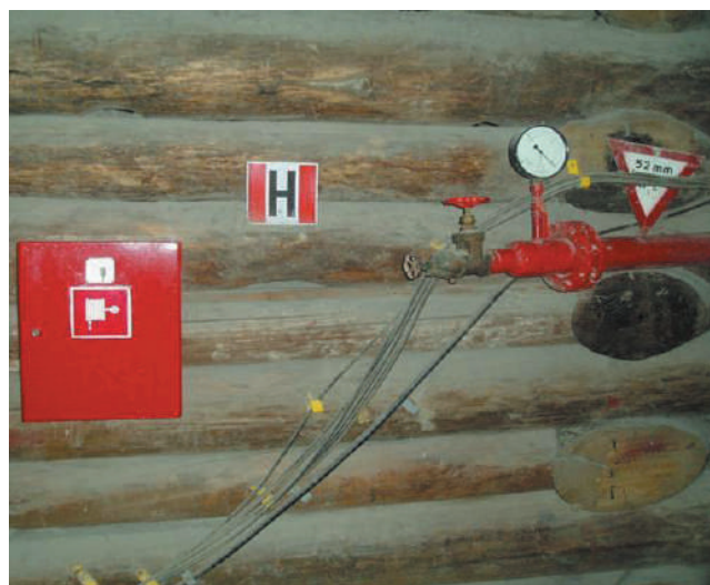
Rys. 1. Rurociąg przeciwpożarowy i skrzynka hydrantowa na kaszcie, w jednej z komór trasy turystycznej
