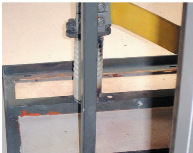
Rys. 16. Uszkodzony izolator wsporczy Fig. 16. Damaged supporting insulator
