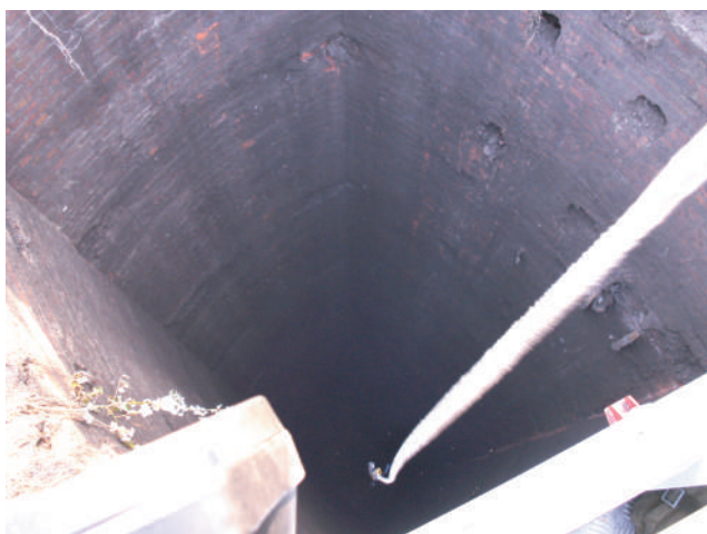
Rys. 3 Detektor gazów MultiRae Plus opuszczany na dno szybu Matylda podczas oceny stanu zagrożenia gazowego (fot.: 22.10.2008 r.)
