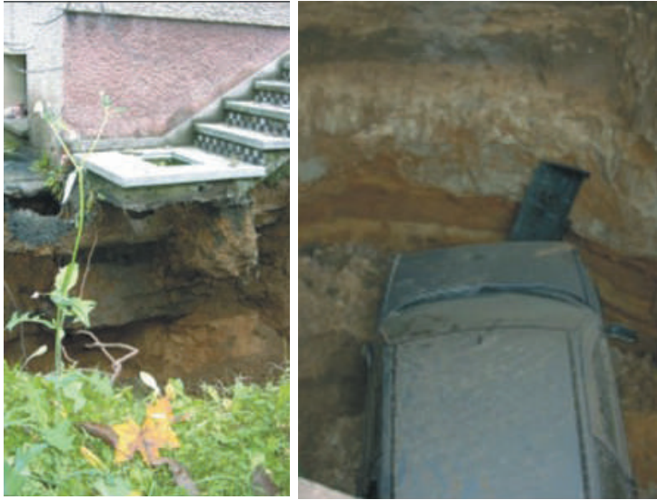
Rys. 1. Katastrofa budowlana w wyniku ekspansji pustek poeksploatacyjnych z pokładu żelaziaka brunatnego w Tarnowskich Górach (fot. J. Radomiński)
