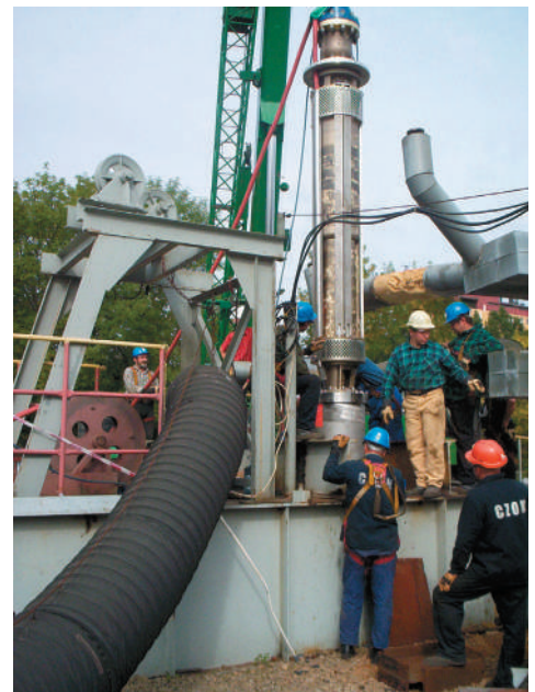
Rys. 3. Widok kompletnego głębinowego agregatu pompowego typu: HDM 6723.1/11 + 6H1147c/900/2TS o mocy 900 kW tuż przed jego zabudową do szybu „Szczepan” pompowni głębinowej „Sosnowiec”, w lutym 2009 roku
