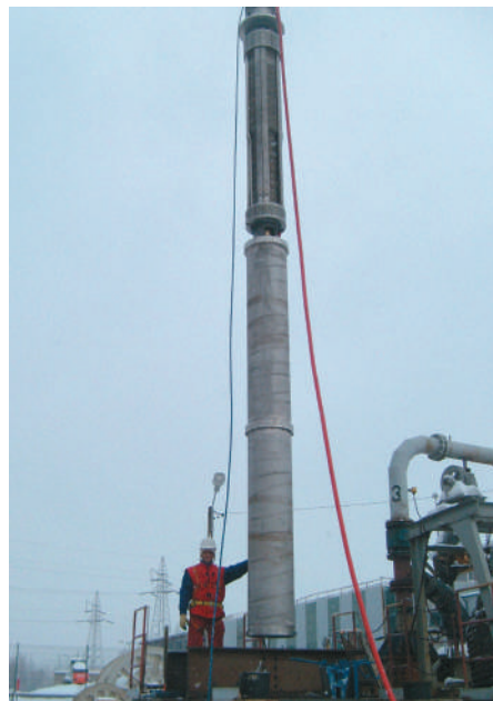
Rys. 2. Widok nadszybia i montaż agregatu HDM na jednym ze stanowisk pompowych
